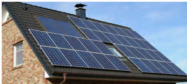
Hausdach mit Photovoltaikanlage zur Stromerzeugung und mit zwei Sonnenkollektoren für das Erwärmen von Wasser. ~ Foto: Pujanak
